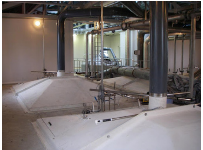
Fig. 2 – Foto degli MBBR coperti. Ref: La gestione degli impianti di depurazione MBBR, Maggioli Editore, 2021
